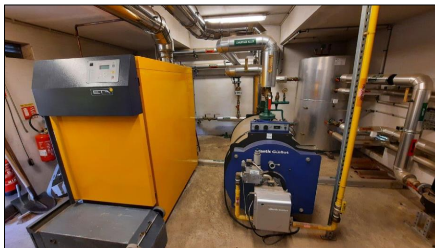
Chaufferie de Castelnaud-Durban. Source : PNRPA.
