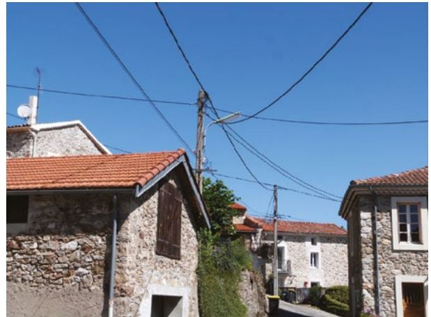
53. Montouliou / exemple de saturation des réseaux aériens dans les villages de caractère
